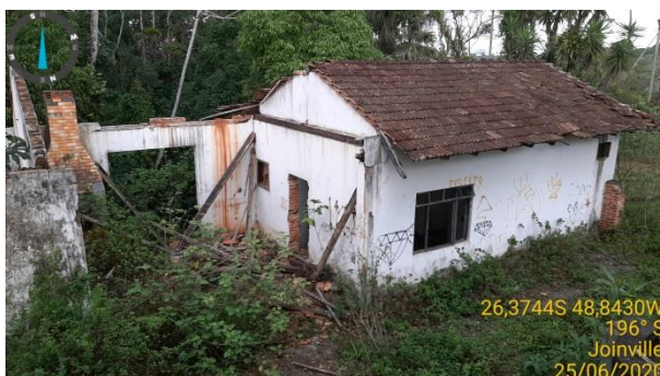
Figura 20: Ruínas da Casa dos Serviços
