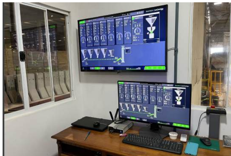
Sala de controle automatizado da linha de produção:
