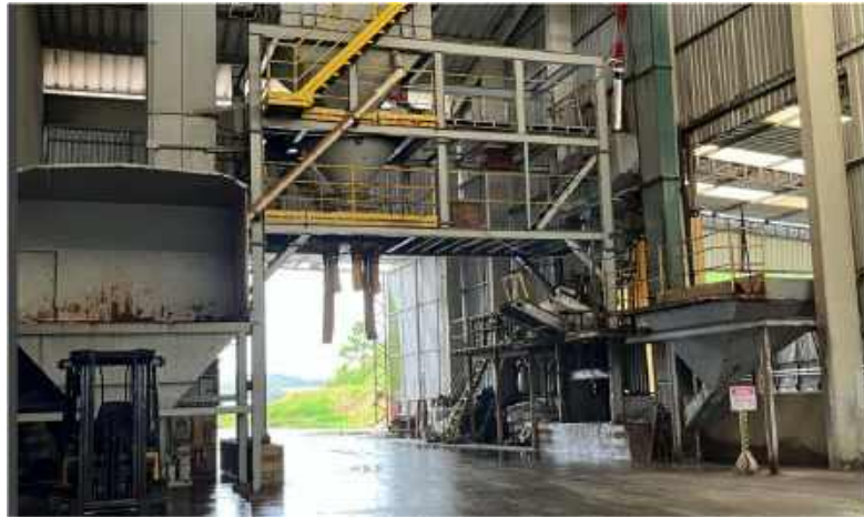
Linha de carregamento a granel
